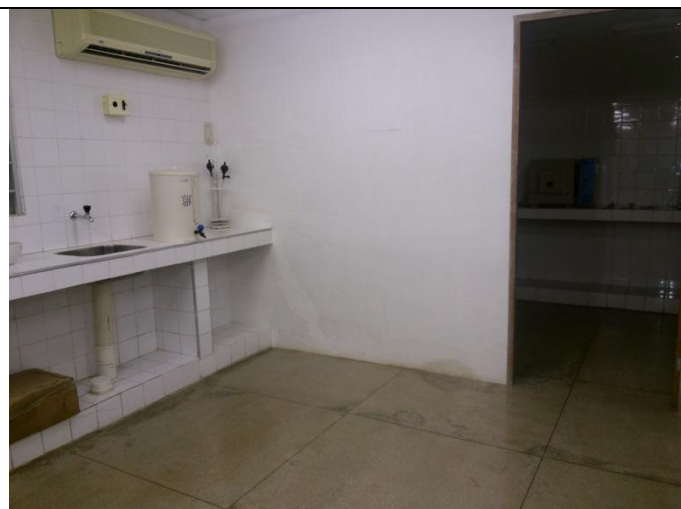
Local aonde será instalado chuveiro lava-olhos
