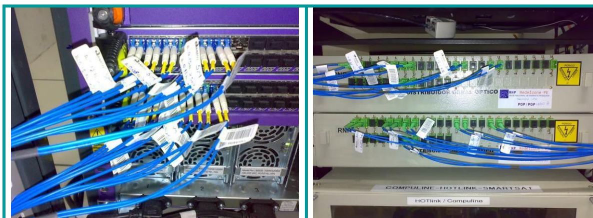
Cordões de Fibras Ópticas no Núcleo de Operação da Rede Ícone
