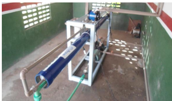
Figura 2.7-9 - Dessalinizador recuperado na localidade de Campo Grande - Águas Belas - PE
