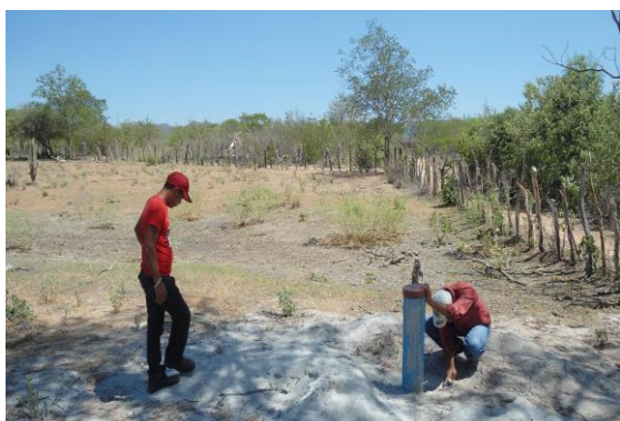
Figura 2.7-5 - Diagnósticos para recuperação no sistema de dessalinização no povoado de Canoas II – Belém de São Francisco - PE
