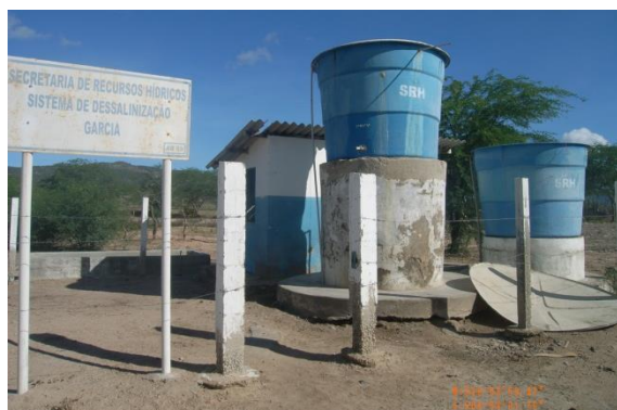
Figura 2.10-19 - Sistema de dessalinização no Município de Águas Belas – Comunidade do Garcia
