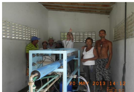
Figura 2.7-16 - Dessalinizador recuperado na localidade de Lagoa Primeira - Bom Conselho – PE.
