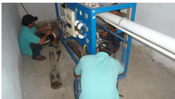
Figura 2.7-31 - Dessalinizador mantido na localidade Sítio Bebedouro – Passira-PE.
