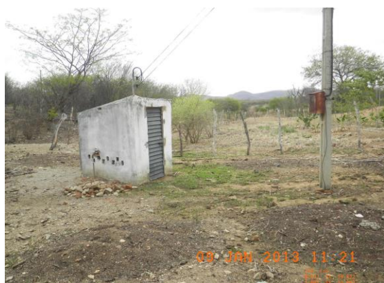
Figura 2.7-1 - Diagnósticos para recuperação no sistema de dessalinização no Sítio Queimadas - Afogados da Ingazeira - PE.
