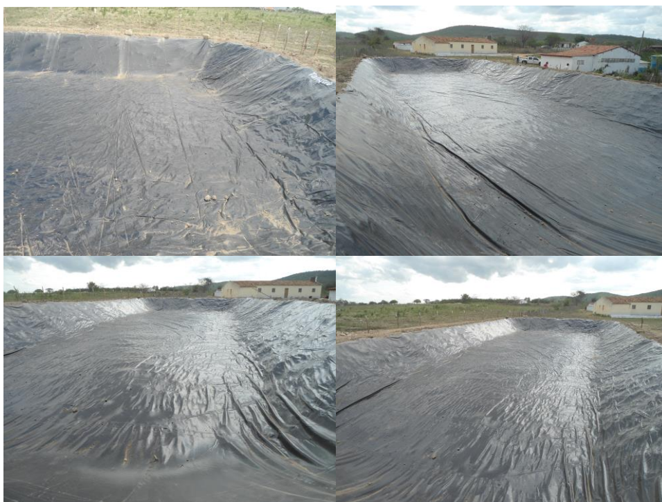
Figura 2.10-9 – Tanque de Rejeito Pronto
