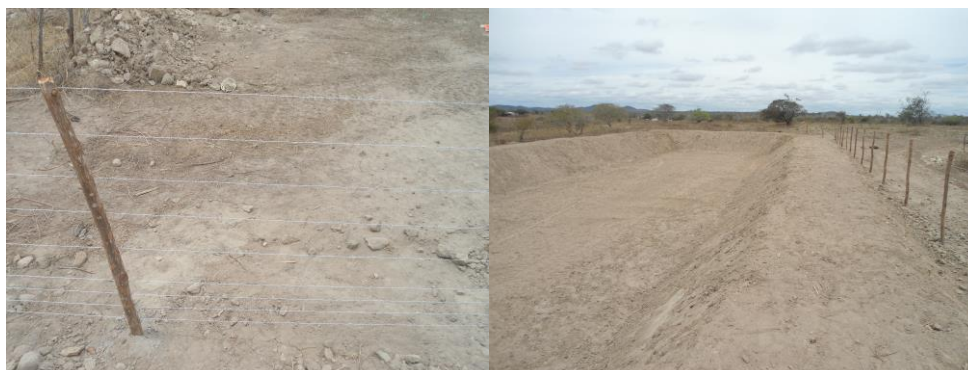
Figura 2.10-8 – Tanque de Rejeito Cercado e Nivelado
