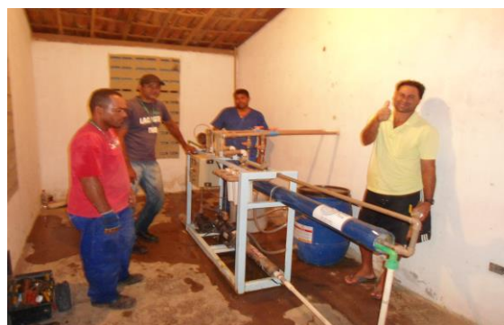
Figura 2.7-6 - Dessalinizador recuperado na localidade de Placa de Piedade – Brejinho-PE
