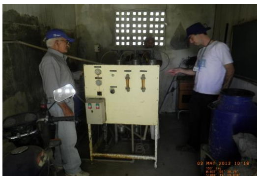
Figura 2.7-15 - Dessalinizador diagnósticos para recuperação no povoado de Poços de Cima Arcoverde – PE.
