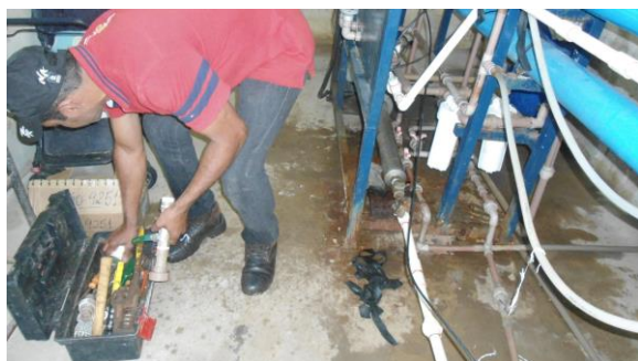
Figura 2.7-29 - Dessalinizador mantido na localidade de Livramento – Vertentes-PE.
