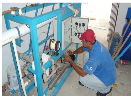
Figura 2.7-2 - Recuperação do sistema de dessalinização na localidade de Guanumby – Buíque-PE.
