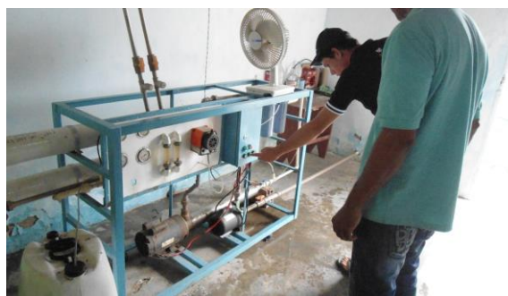
Figura 2.7-32 - Dessalinizador mantido na localidade de Varjada de Cima – Passira-PE.
