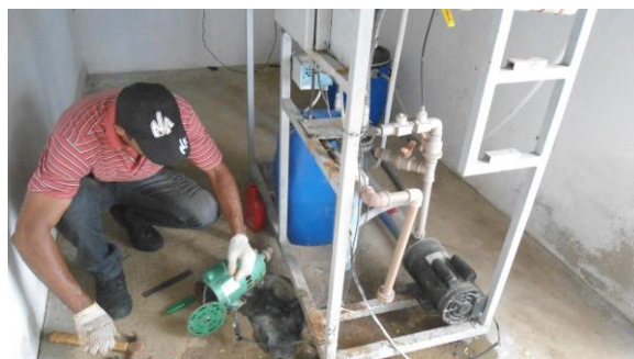
Figura 2.7-30 - Dessalinizador mantido na localidade de Lagoa da Cobra – Bom Jardim-PE.
