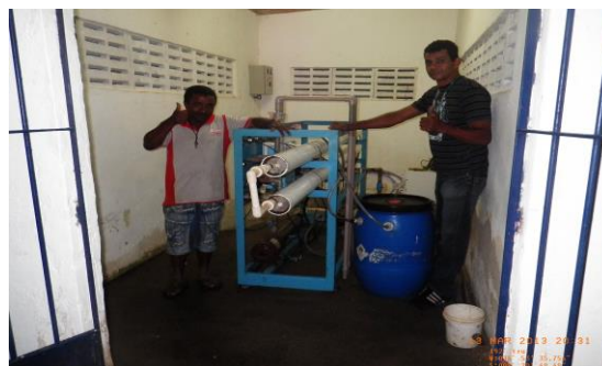
Figura 2.7-10 - Dessalinizador recuperado na localidade de Pau Santo - Caruaru - PE
