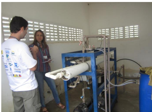
Figura 2.10-29 - Vista do Sistema de dessalinização Sítio Baraúna– Município de Pesqueira
