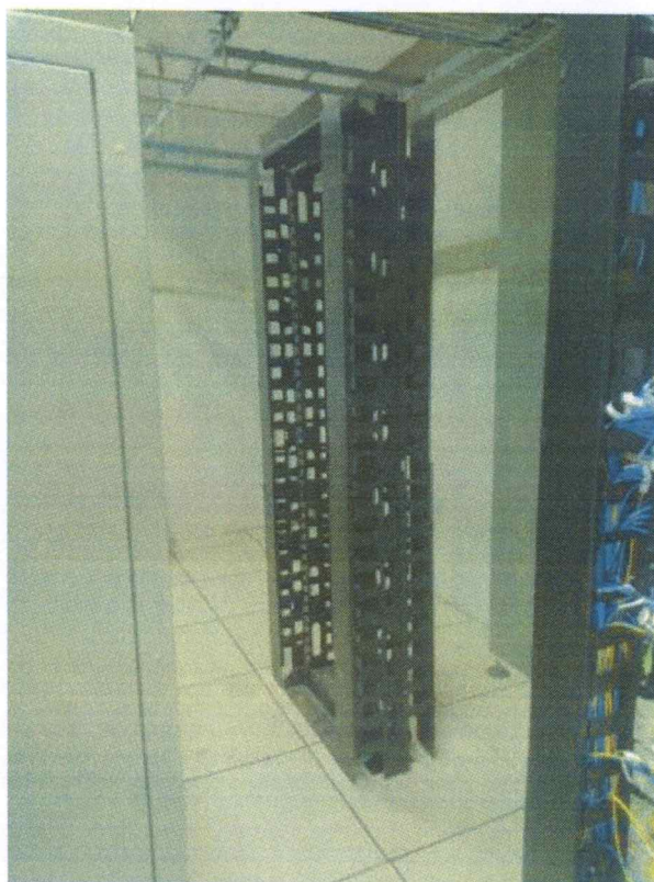
Figura 23 - Racks que receberão novos DGOs do IX.BR.
