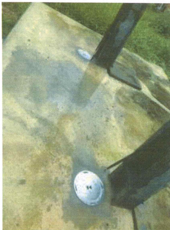
Figura 22 - Aterramento nas duas subestações
